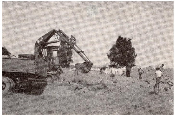
La pelle entre en action. Avec le mois de Juillet 1964 les travaux commencent
